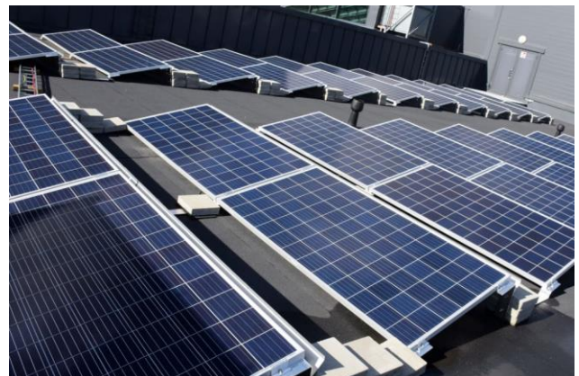
Aurinkopaneelit kauppakeskuksen katolla (Kuva: Yle)
